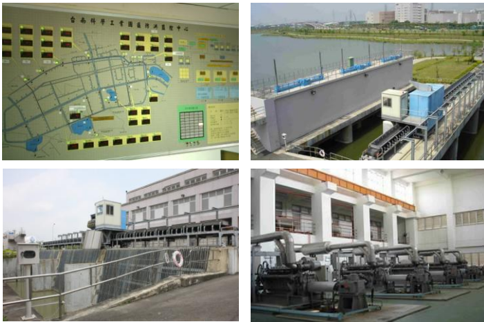
▲ 水位監控系統、水閘門與抽水機
