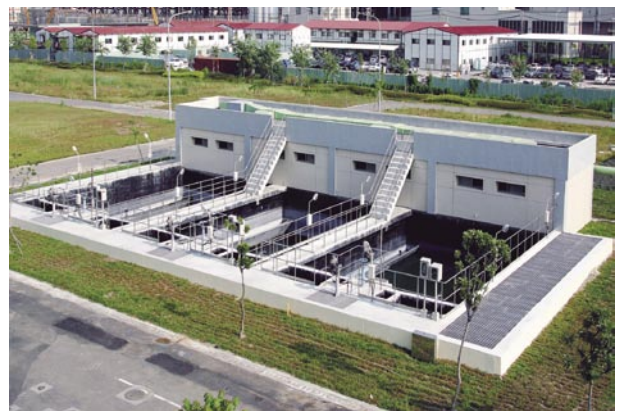
▲ 環工中心污水處理廠
