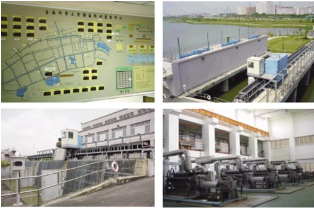
▲ 水位監控系統、水閘門與抽水機
