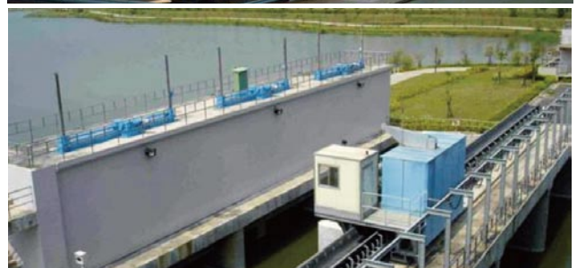
▲ 水位監控系統、水閘門與抽水機
