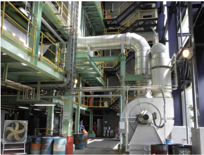
▲ 廢棄物焚化處理設施
